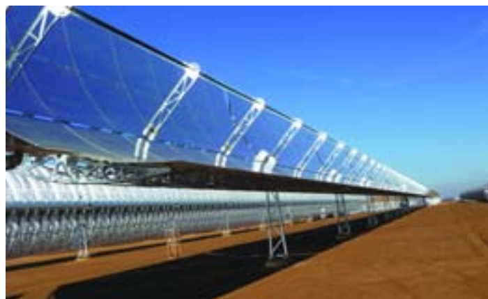
Sistema de SENERthrough que se va a instalar en Valle 1 y Valle 2.
