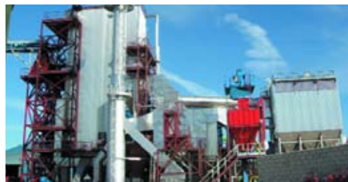
Planta de Cogeneración en Cabra (Córdoba)-Producción de vapor sobrecalentado 405°C de 35 Tn/h a 42 bar-Acuotubular-Combustible: Orujillo-Emissiones referidas al 11% de O2: CO(100mg/m3N - NOx (200mg/m3N - Partículas: 50 mg/m3N - Producción eléctrica: 8 Mwe
