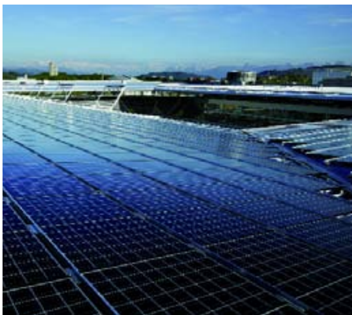
Instalación fotovoltaica de 1,35 MW con paneles Kyocera, en Berna sobre el Stade de Suisse
